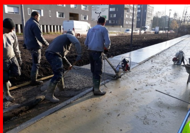
Le tirage du béton au rouleau Striker. Il n'a pas été vibré pour ne pas faire descendre le granulat, qui doit rester en surface pour le bon aspect visuel de la finition piquée.
