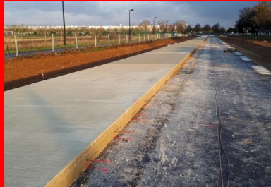
Afin de maintenir fermé le joint longitudinal, des fers de liaison ont été insérés dans le béton frais avec un espacement d'un mètre.
