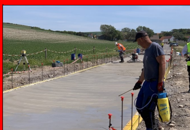
Pulvérisation d'un produit de cure à la surface du béton frais pour le protéger de la dessiccation.
