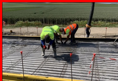
Après avoir posé les armatures longitudinales sur les distanciers, l'équipe les ligature avec un recouvrement de 64 cm.
