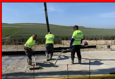
Bétonnage : alimentation du béton à la pompe, réglage au râteau, suivi du serrage du béton à l'aiguille vibrante.
