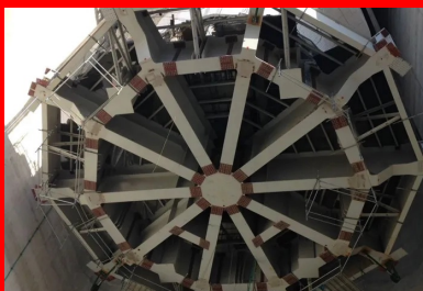
Le four solaire commence son ascension, hissé par vingt vérins avaleurs de câbles.
