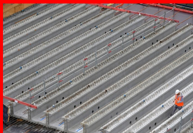
Le tablier est constitué de poutres préfabriquées en béton en forme de T inversé.
