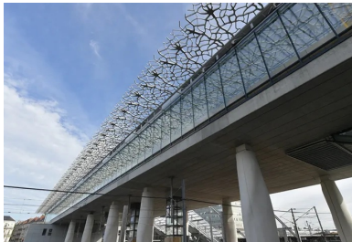
Les baies vitrées sont protégées des apports solaires par des ombrières en BFUP.
