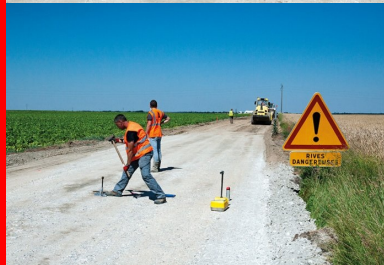
Contrôle de la compacité et de la teneur en eau de la chaussée à l'aide d'un gammadensimètre.
