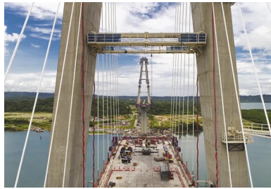
Pendant les travaux, afin d'éviter que les efforts soient trop importants en pied de pylônes, des butons provisoires étaient installés entre les deux jambes.
