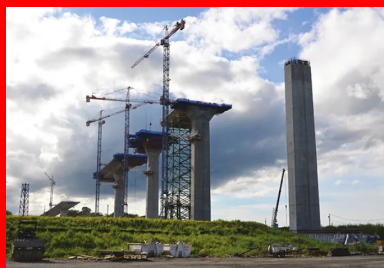
Les voussoirs du tablier des viaducs d'accès côté canal ont été construits en béton coulé en place par encorbellements successifs.
