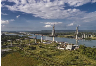
Les voussoirs du pont à haubans sont construits de manière symétrique par rapport à chacun des pylônes, afin d'éviter le déséquilibre des charges.
