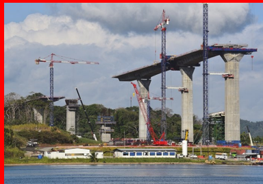
Pour éviter de multiplier les transports par barges à travers le canal, la quasi-totalité des éléments structurels sont coulés en place.
