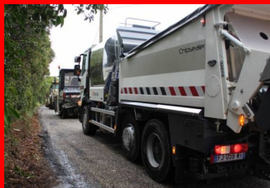
Difficulté : l'étroitesse des voies ( \leq 3,50 m).
