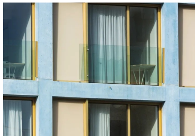
Les baies dessinées par la trame structurelle sont fermées par des pans de verre émaillé et transparents toute hauteur.
