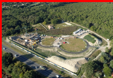
Implantés à quelques mètres de la départementale, les deux bassins enterrés, recouverts d'herbe, sont totalement invisibles, un talutage sépare le site d'avec la route.
