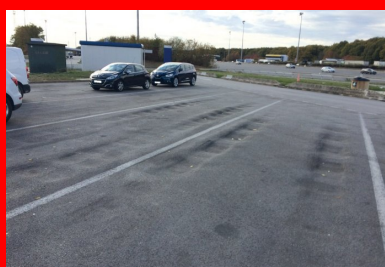
Les aires de stationnement en enrobé bitumineux sont sujettes à des déformations, notamment à un important orniérage et à du « fluage », ce qui impose un entretien répétitif.
