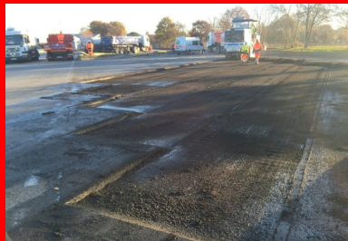
Le béton a été mis en œuvre sur 10 cm d'épaisseur et vibré à l'aide d'aiguilles vibrantes et d'une règle vibrante.
