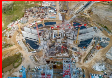
Le massif de lancement est le cœur battant d'ELA 4, c'est sur cet ouvrage semi-enterré en béton armé que s'appuiera le lanceur pour décoller.
