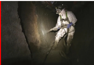
Projection de mortier renforcé de fibres métalliques amorphes pour le renforcement de réseaux hydrauliques.
