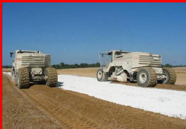
Traitement des sols - Un malaxeur mélange le liant hydraulique routier avec le sol
