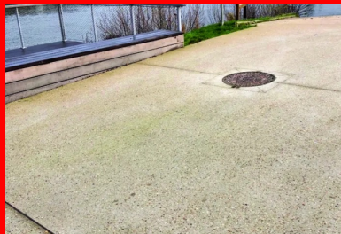
Le cheminement s'ouvre régulièrement, côté fluvial, sur des aménagements - façon belvédères - avec points de vue avancés sur la Seine (en arrière-plan). Au premier plan et en médiation, un joint de dilatation.
