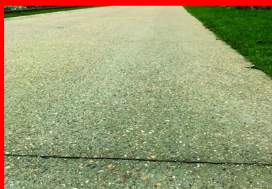
Le cheminement s'ouvre régulièrement, côté fluvial, sur des aménagements – façon bevédères – avec points de vue avancés sur la Seine (en arrière-plan). Au premier plan et en médaillon, un joint de dilatation.
