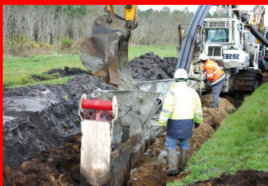
Disposés en tréfile au fond de la tranchée, les câbles sont recouverts de remblai liquide, puis la tranchée est comblée avec la terre excavée. Un grillage de plastique rouge inséré dans la tranchée signale la présence de la ligne haute tension.
