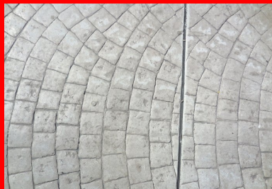
La zone d'arrêt du bus est matérialisée au sol par une finition en béton imprimé.
