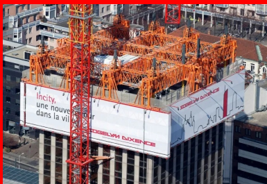
Déconstruction douce grâce à un système de protection qui descend au fur et à mesure de la démolition.
