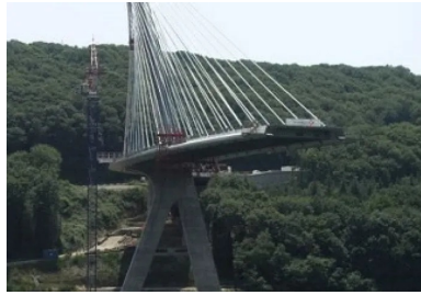
Construction du pont à haubans de Térénez (29), inauguré en 2011 : pylône en lambda renversé. (c) photo Noëli Richet
