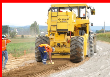
Derrière le malaxeur Bomag RS 650, un technicien vérifie visuellement l'homogénéité du mélange entre le matériau de l'ancienne chaussée et le liant hydraulique, et un autre mesure la teneur en eau du matériau traité.
