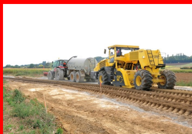
Derrière le malaxeur Bomag RS 650, un technicien vérifie visuellement l'homogénéité du mélange entre le matériau de l'ancienne chaussée et le liant hydraulique, et un autre mesure la teneur en eau du matériau traité.
