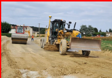
Dernière le malaxeur, la mise en œuvre se poursuit avec le nivellement de la chaussée (à droite) et le compactage du matériau (à gauche).
