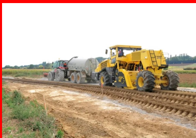
Derrière le malaxeur Bomag R5 650, un technicien vérifie visuellement l'homogénéité du mélange entre le matériau de l'ancienne chaussée et le liant hydraulique.
