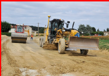
Derrière le malaxeur, la mise en œuvre se poursuit avec le nivellement de la chaussée (à droite) et le compactage du matériau (à gauche).
