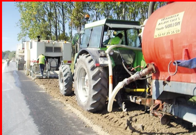
L'atelier de retraitement de chaussée réalise plusieurs opérations : fraissage, épandage et malaxage.
