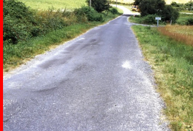
Vue générale d'une route dégradée structurellement
