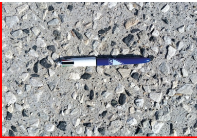
Le granulats 8/20 utilisé pour les places de stationnement s'incorpore aisément dans le béton et résiste bien à l'arrachement.
