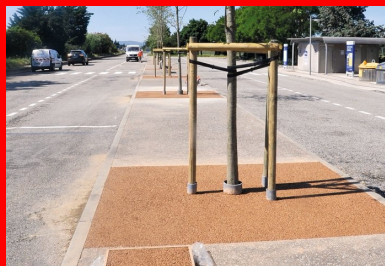
Peu après 12 heures, sur l'aire de repos de Bellevue, A7, sens Lyon-Marseille, au kilomètre 86. Les travaux sont achevés. Une planche d'échantillonnage a été réalisée. Elle servira à confirmer les performances du béton drainant.
