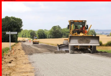
Passage de la niveleuse pour un bon uni et le meilleur profil géométrique possible.
