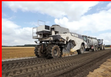
L'atelier de retraitement avec une citerne à eau asservie.
