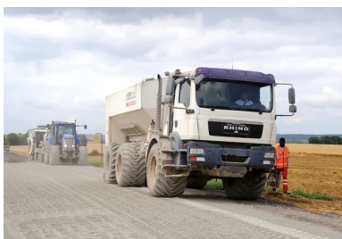
Épandage du liant hydraulique routier LVTS 54 de Vicat et vérification de la bonne répartition du liant au mètre carré (méthode dite « à la bêche »).
