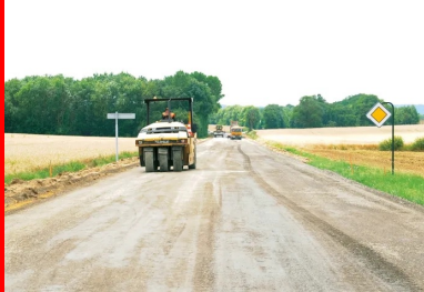
L'atelier de compactage composé d'un « vibrant » (un cylindre monorouleau V5) et d'un « pneu » (un PS 300).
