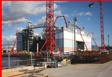
Le bétonnage continu des caissons est réalisé par l'intermédiaire de trois mâts de bétonnage, reliés sur le quai à trois pompes à béton, alimentées par des camions toupies béton.
