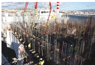
Le coulage de chaque caisson dans un coffrage glissant intégral est réalisé en continu 24 h/24 et 7 j/7. L'élévation moyenne est fixée à 12 cm/h.
