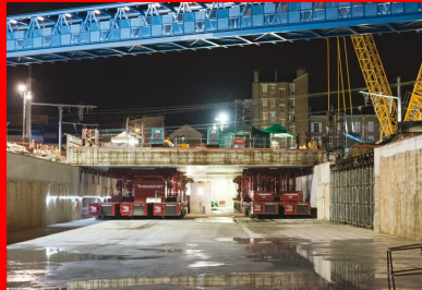
Ripage de la dalle de couverture pour la gare Fort d'Issy-Vanves - Clamart
