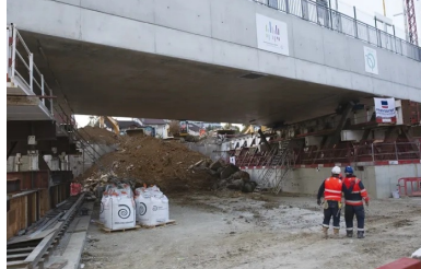
Pont-dalle à Arcueil - Cachan. Après le coulage et quelques jours avant le ripage.
