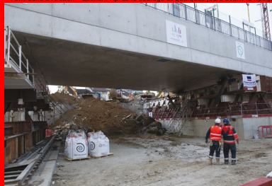
Pont-dalle à Arcueil - Cachan. Après le coulage et quelques jours avant le ripage.
