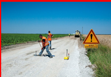
À droite, contrôle de la régularité de l'épandage et de la quantité des liants réalisé par la méthode dite « à la bêche ». À gauche, préparation d'un test de compacité. En médaillon, résultat à l'issue du malaxage : le liant clair a été finement mélangé avec le matériau de l'ancienne chaussée.
