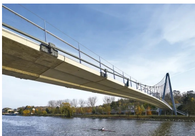
Le tablier en béton franchit l'Oise en une seule travée de 80 m.
