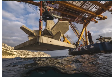
Dans le parc des Calanques, mise à l'eau du Fractal®, avec des moyens de levage exceptionnels.
