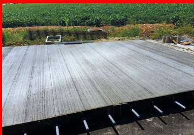
Les goujons métalliques d'une longueur de 0,45 m et d'un diamètre de 30 mm.
