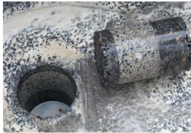
Carotte prélevée dans une chaussée composite illustrant parfaitement le collage BAC sur GB3.
